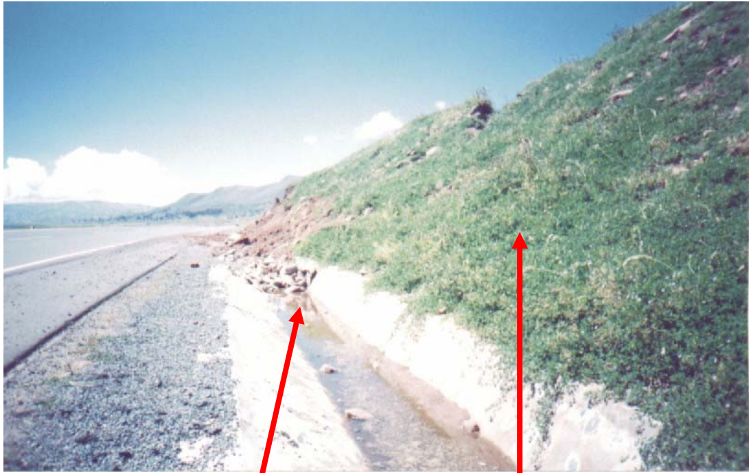
DERRUMBE QUE OBSTRUYE CUNETETA
